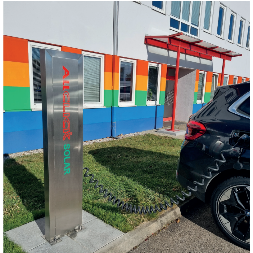
Die selbst designte Ladestation für den E-Fuhrpark
